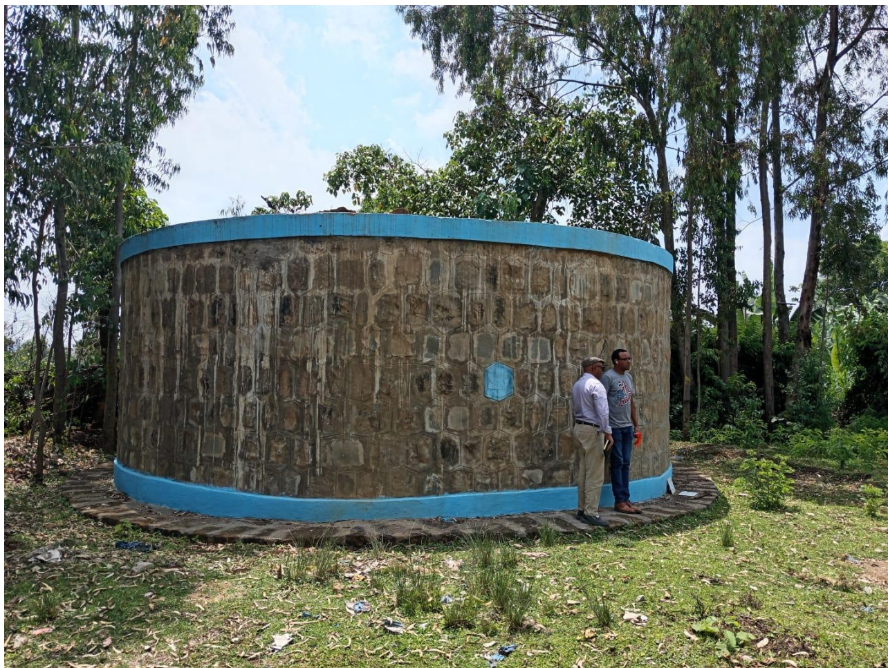
Pozzo Mesena Bako - Cisterna in cemento capienza 100.000 litri
